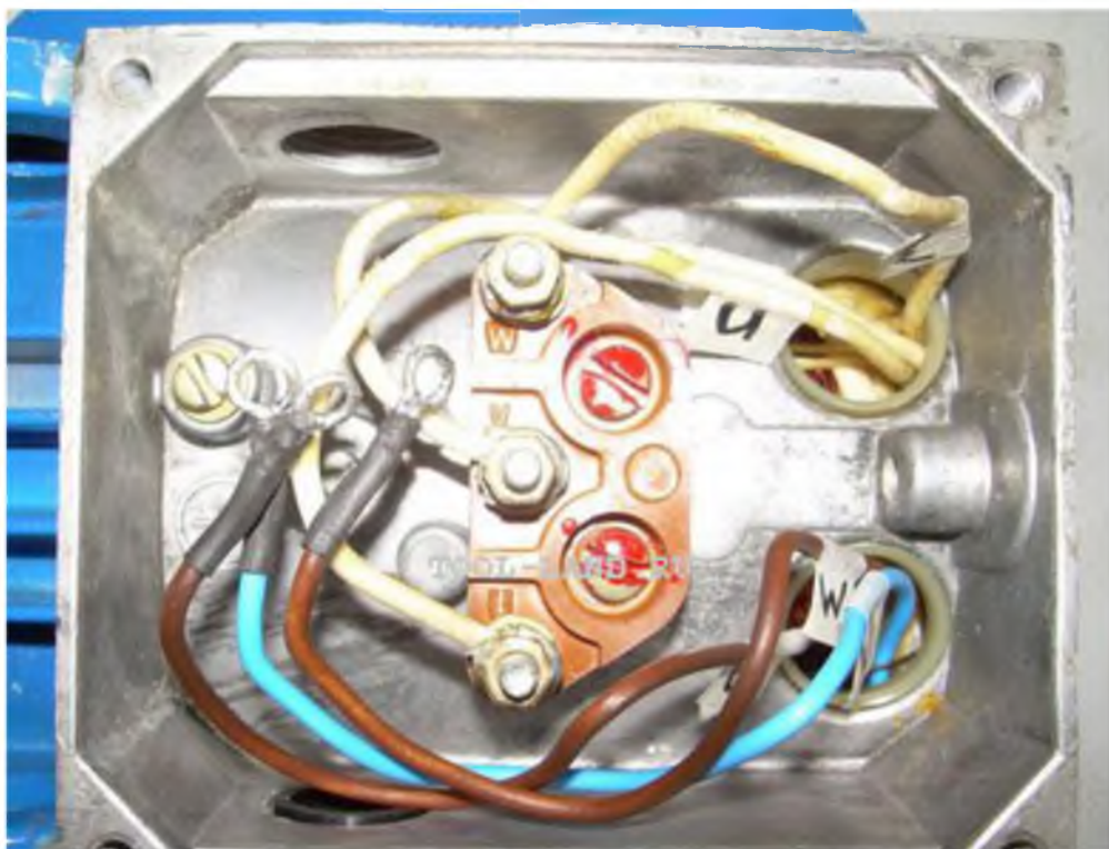
Вывод проводов в клеммную коробку
