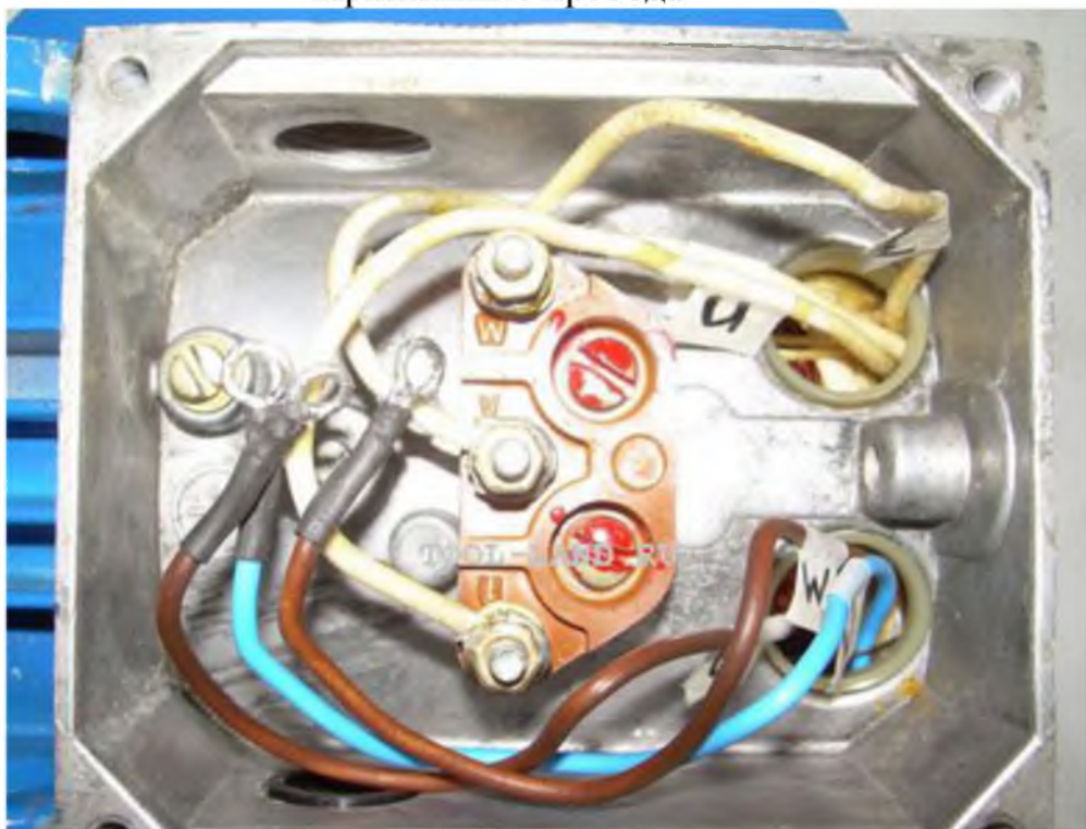
Вывод проводов в клеммную коробку
